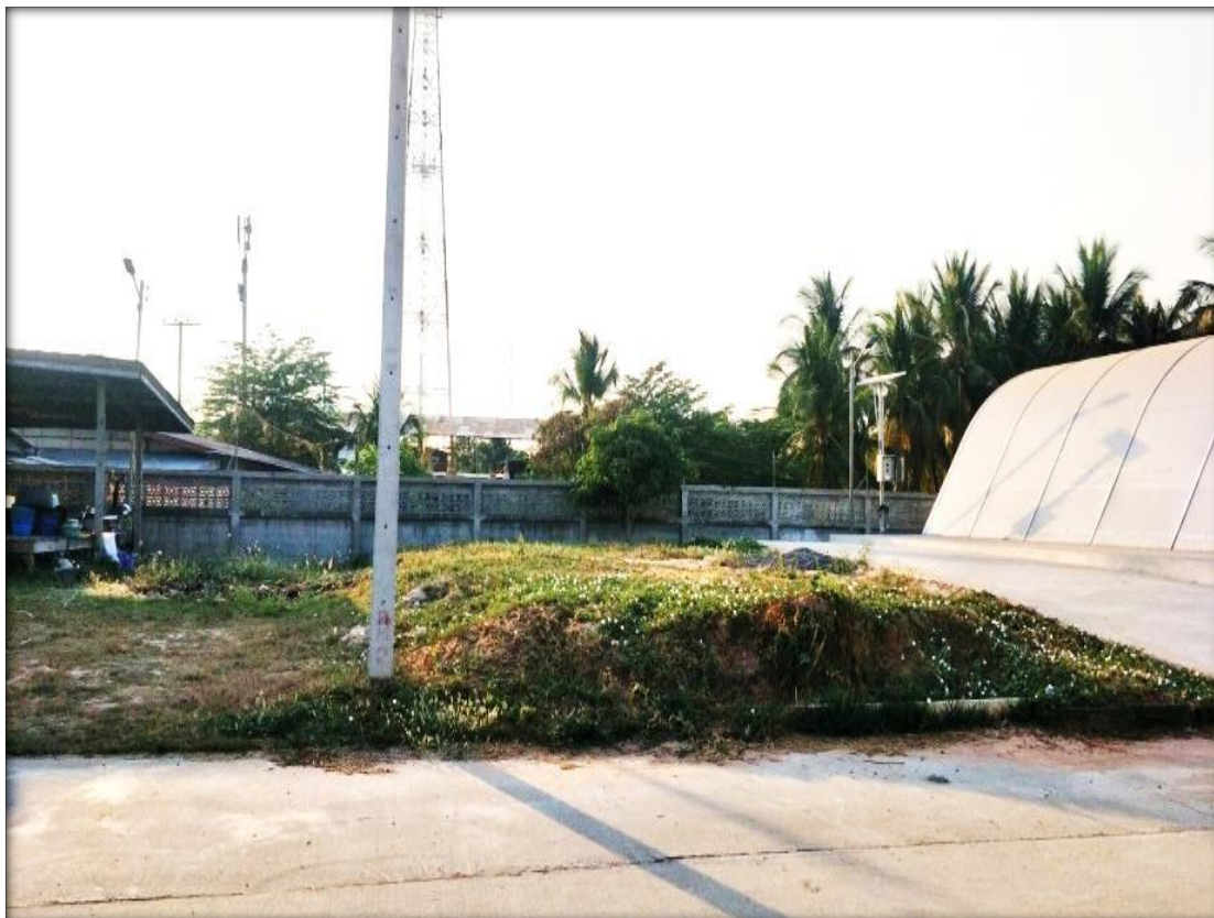
ภาพที่ ๑ พื้นที่ก่อสร้างสิ่งปลูกสร้างพร้อมครุภัณฑ์ โรงพยาบาลขุนหาญ ช้างโรงตากพลังงานแสงอาทิตย์
