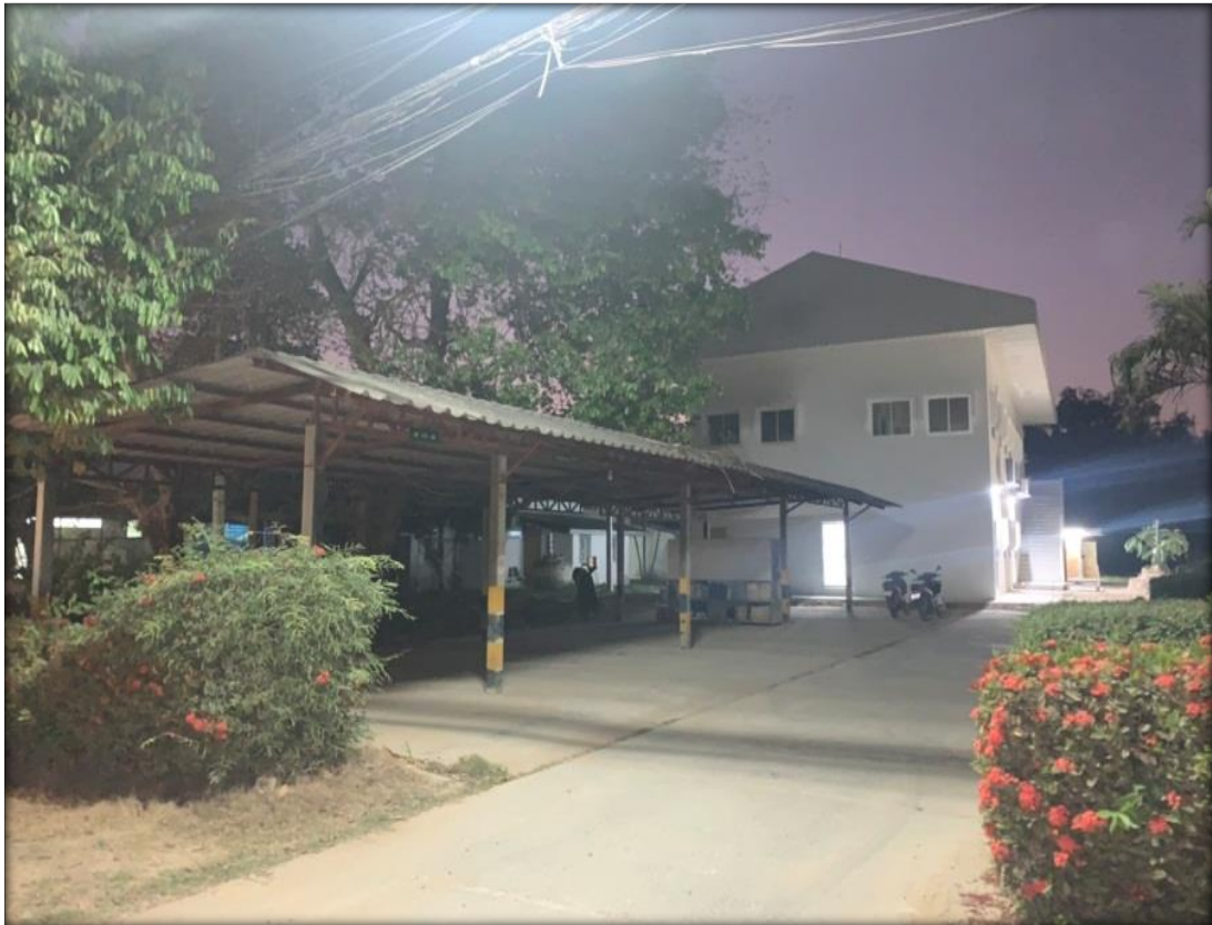
ภาพที่ ๓ พื้นที่ก่อสร้างสิ่งปลูกสร้างพร้อมครุภัณฑ์ โรงพยาบาลห้วยทับทัน บริเวณข้างอาคารแปรรูปสมุนไพร
