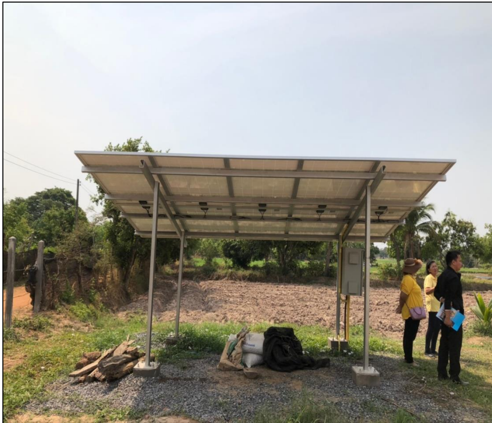
ภาพที่ ๑ บริเวณพื้นที่ก่อสร้างฐานรองรับแผงโซล่าเซลล์ จำนวน ๒๕ ชุด
